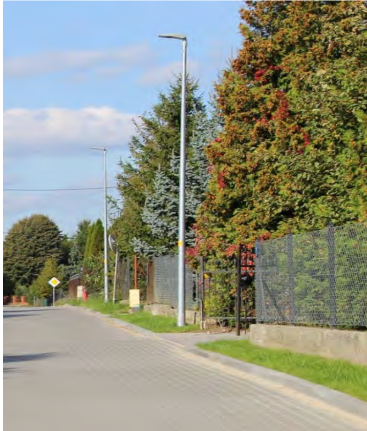
Oświetlenie przy ul. Ogrodowej w Juszkowie
