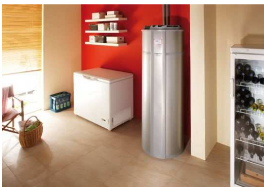
Widok pompy ciepła
